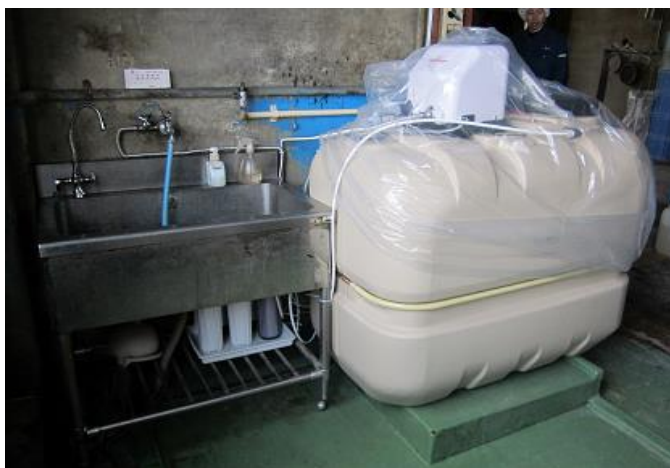
本体+2500タンク(ポリエチレン) /製菓工場
